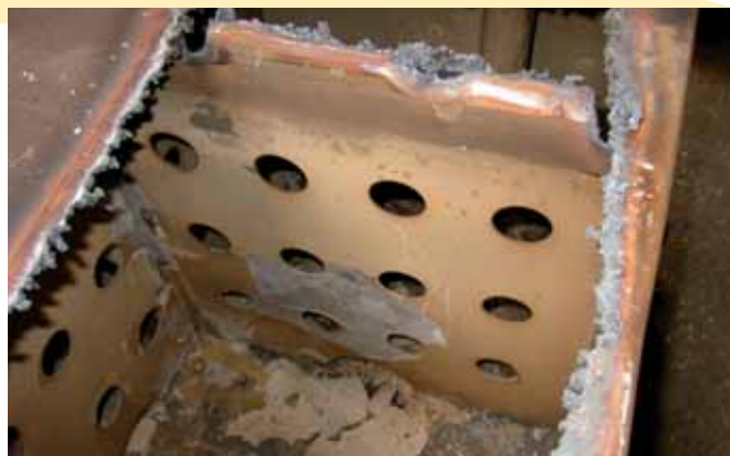
Usazeniny a zbytky na stěnách a dně vodní nádrže – Zdroj: ISPEL.
